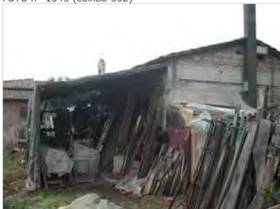
Categoria: Degrado architettonico/incongruità
