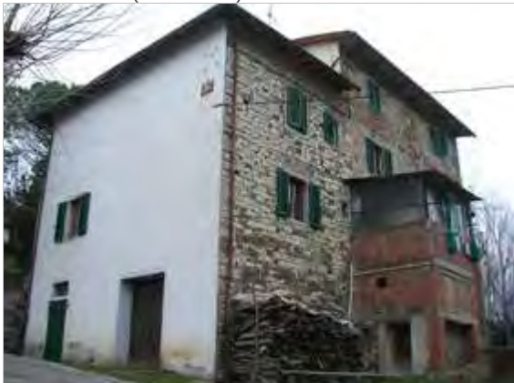
Categoria: Degrado architettonico/incongruità
