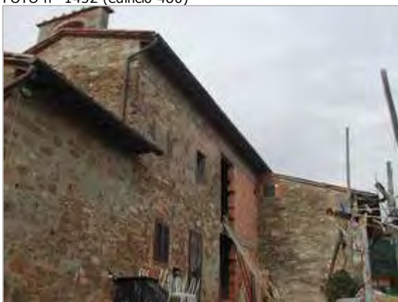
Categoria: Degrado architettonico/incongruità
