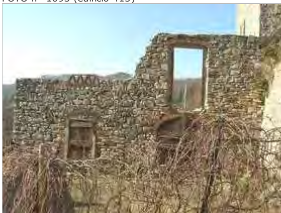
Categoria: Degrado architettonico/incongruità
