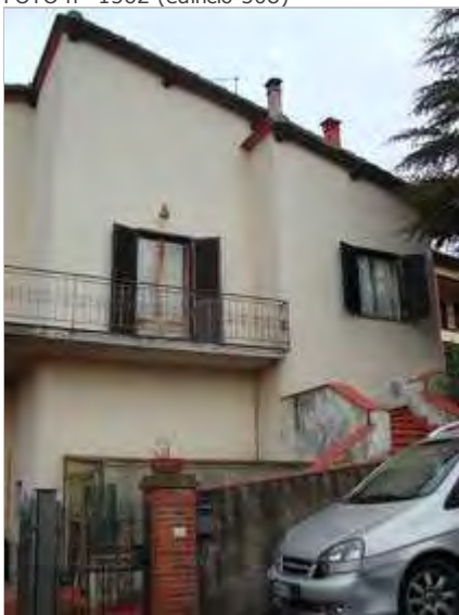
Categoria: Degrado architettonico/incongruità
