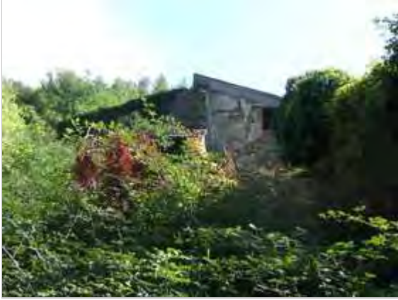
Categoria: Degrado fisico
