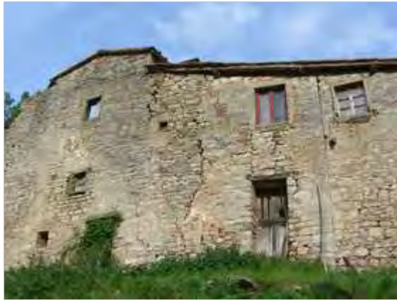
Categoria: Degrado fisico
