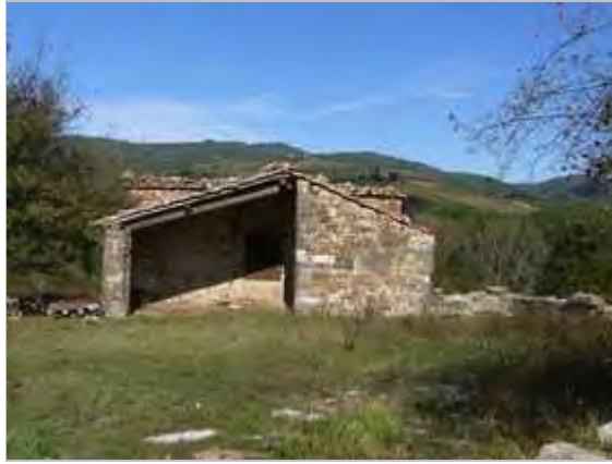
Categoria: Degrado fisico
