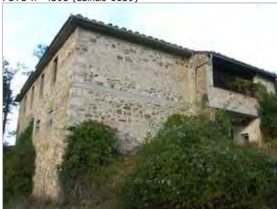
Categoria: Degrado fisico
