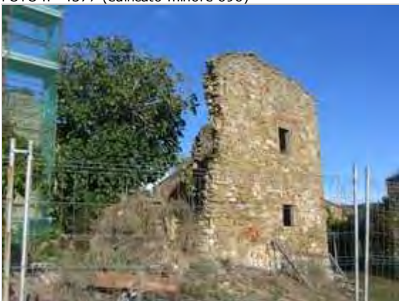
Categoria: Degrado fisico
