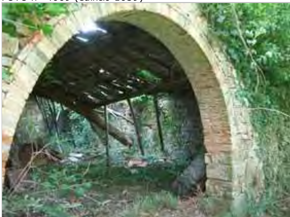
Categoria: Degrado fisico
