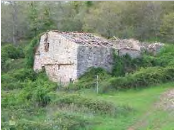
Categoria: Degrado fisico
