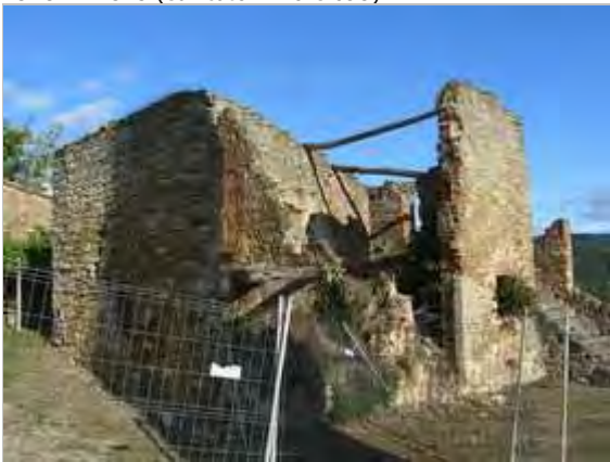
Categoria: Degrado fisico
