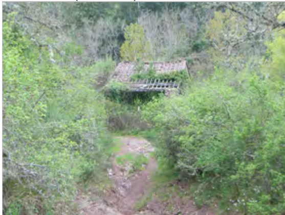
Categoria: Degrado fisico
