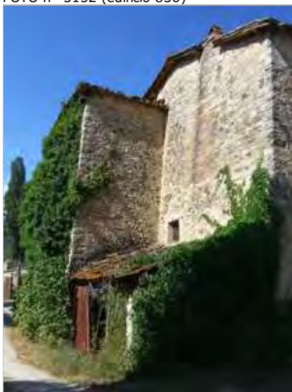
Categoria: Degrado fisico
