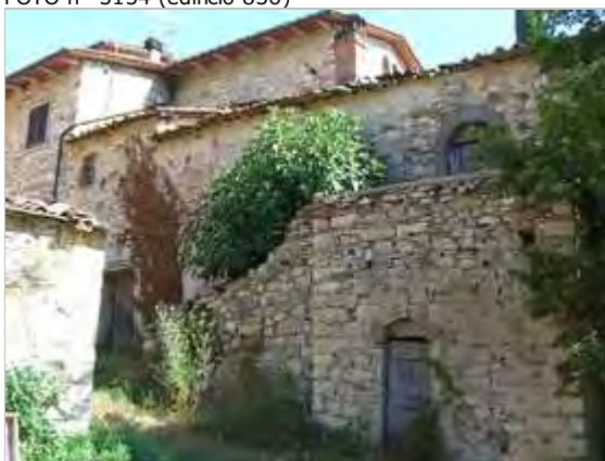
Categoria: Degrado fisico
