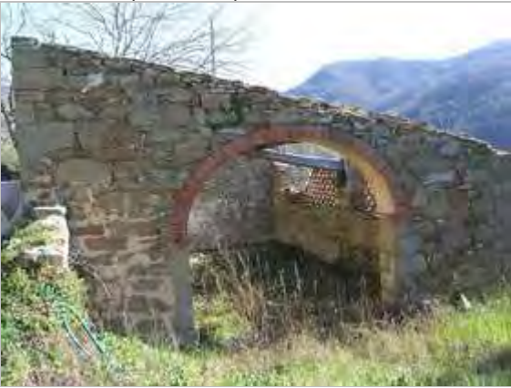
Categoria: Degrado fisico
