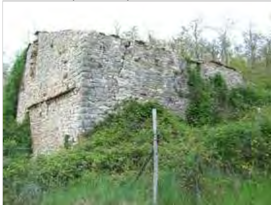
Categoria: Degrado fisico
