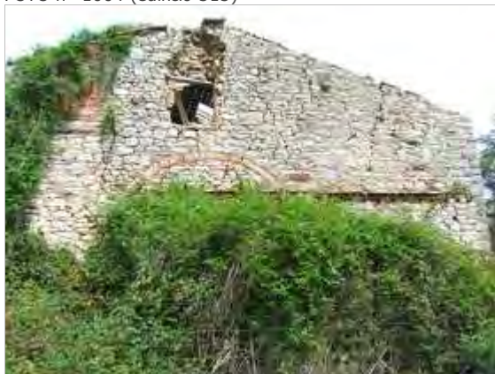
Categoria: Degrado fisico
