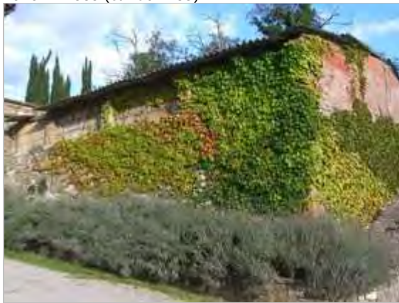
Categoria: Degrado fisico
