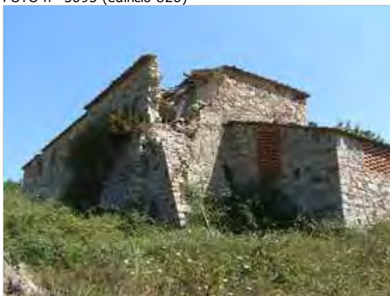
Categoria: Degrado fisico
