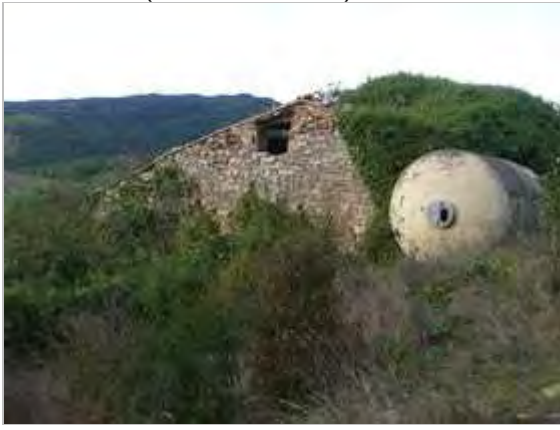
Categoria: Degrado fisico
