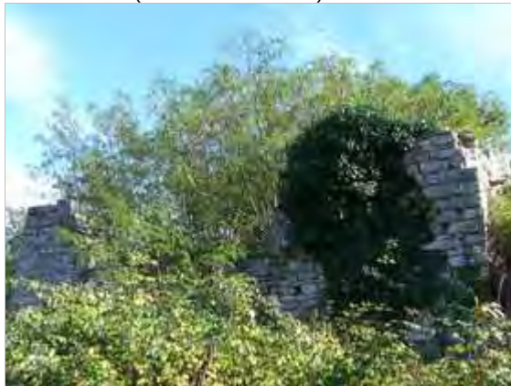
Categoria: Degrado fisico
