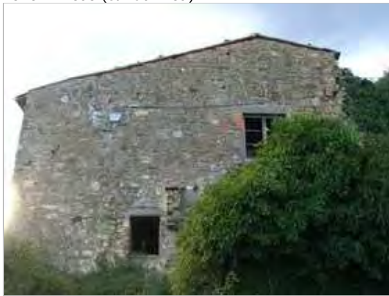
Categoria: Degrado fisico
