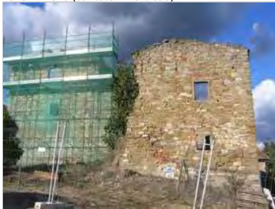
Categoria: Degrado fisico
