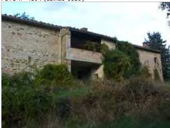
Categoria: Degrado fisico
