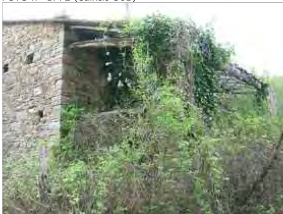
Categoria: Degrado fisico
