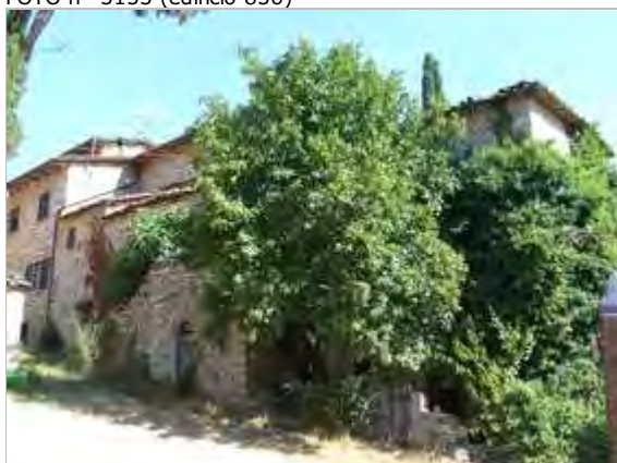
Categoria: Degrado fisico
