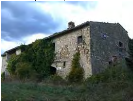
Categoria: Degrado fisico
