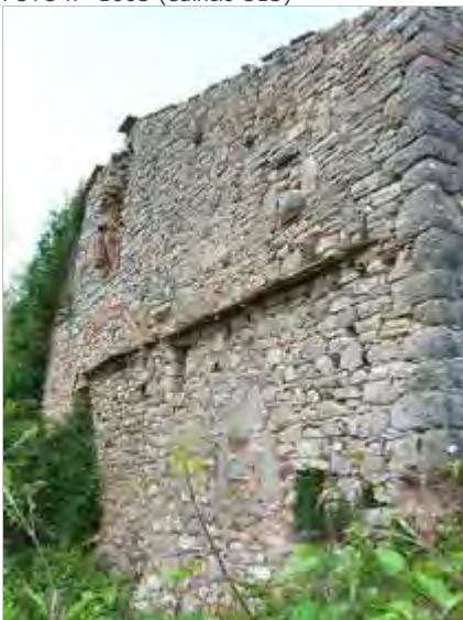
Categoria: Degrado fisico
