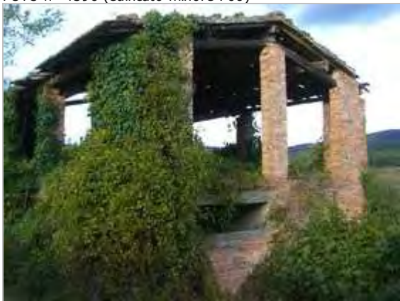
Categoria: Degrado fisico
