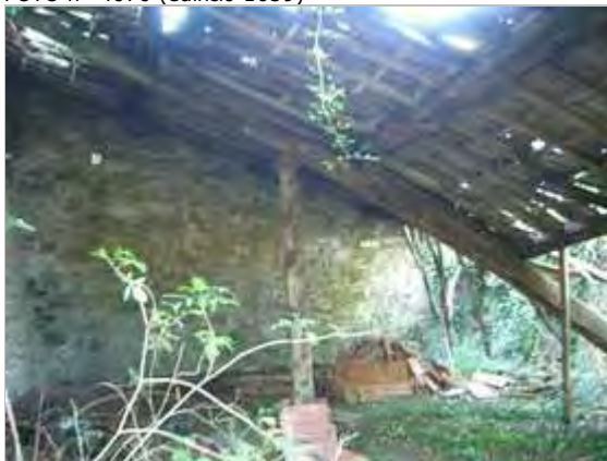
Categoria: Degrado fisico
