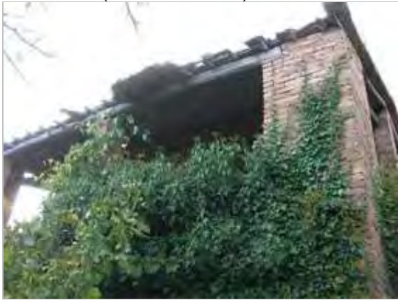
Categoria: Degrado fisico
