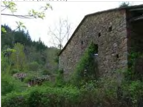
Categoria: Degrado fisico
