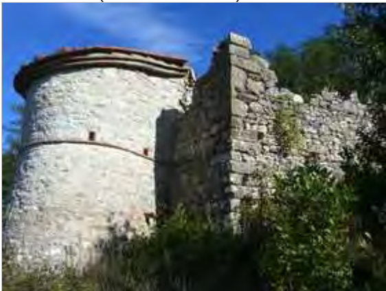
Categoria: Degrado fisico
