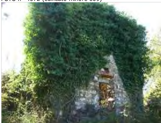
Categoria: Degrado fisico
