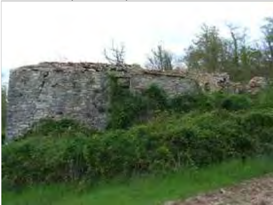
Categoria: Degrado fisico
