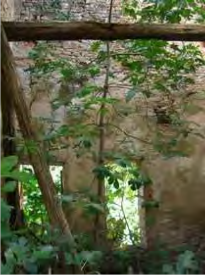
Categoria: Degrado fisico
