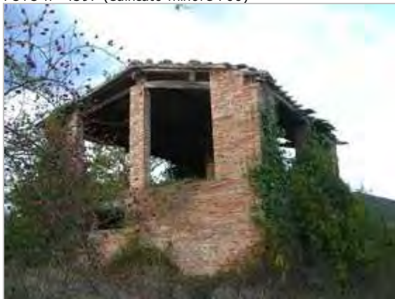
Categoria: Degrado fisico
