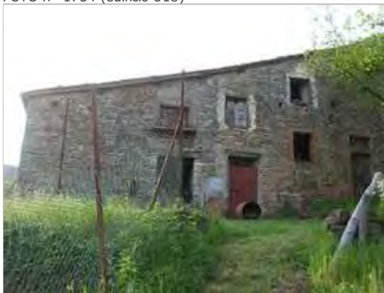
Categoria: Degrado fisico
