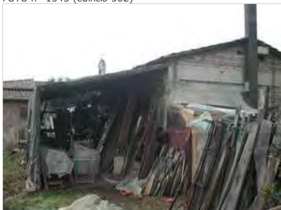
Categoria: Degrado architettonico/incongruità
