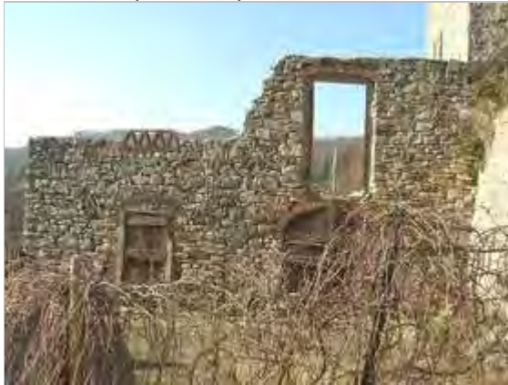
Categoria: Degrado architettonico/incongruità
