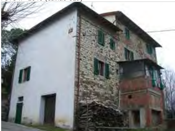
Categoria: Degrado architettonico/incongruità
