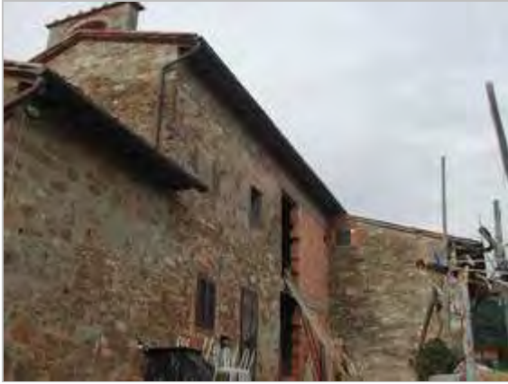
Categoria: Degrado architettonico/incongruità
