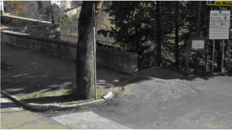
Fotografia 7 - In corrispondenza del secondo attraversamento pedonale si riscontra da una parte un piccolo scalino e dall'altra invece si ha una soluzione di continuità del piano di calpestio. La pavimentazione risulta comunque parzialmente sconnessa lungo tutto il marciapiede a causa della presenza delle radici degli alberi leggermente affioranti. Sono comunque assenti le differenziazioni tattili delle pavimentazioni all'attraversamento pedonale ad uso delle persone cieche.
