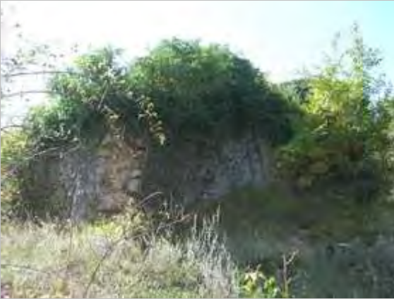
Categoria: Degrado fisico
