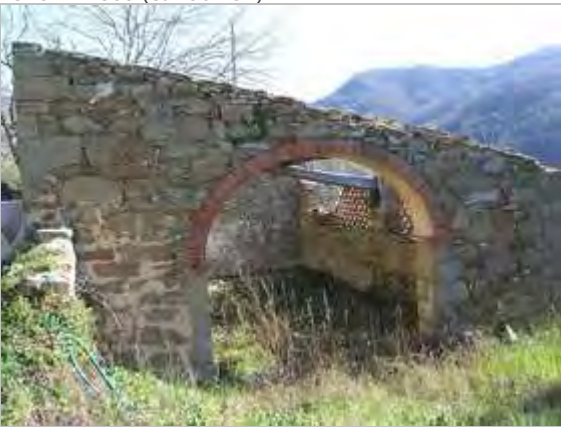
Categoria: Degrado fisico
