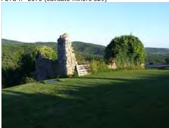
Categoria: Degrado fisico
