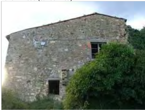
Categoria: Degrado fisico
