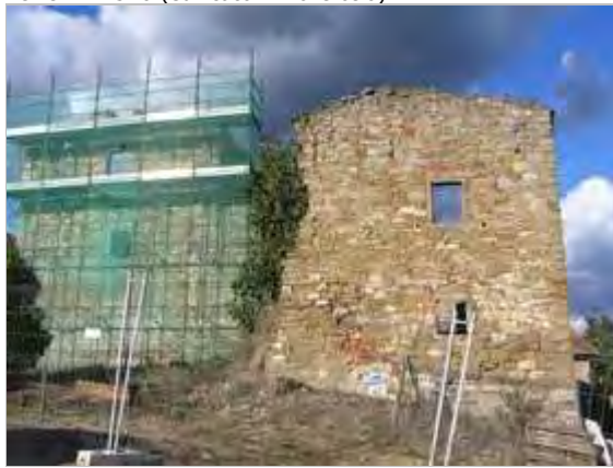
Categoria: Degrado fisico
