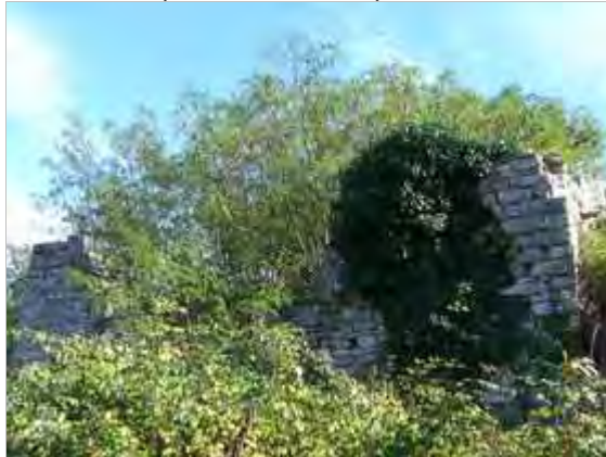
Categoria: Degrado fisico
