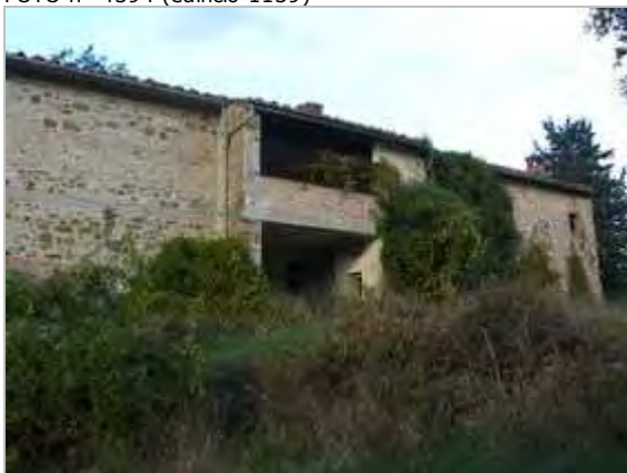
Categoria: Degrado fisico
