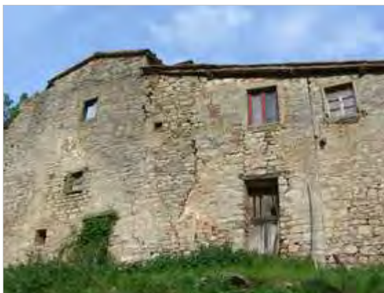
Categoria: Degrado fisico
