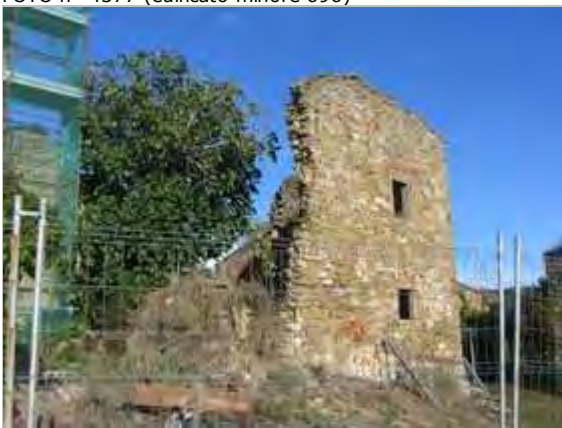
Categoria: Degrado fisico
