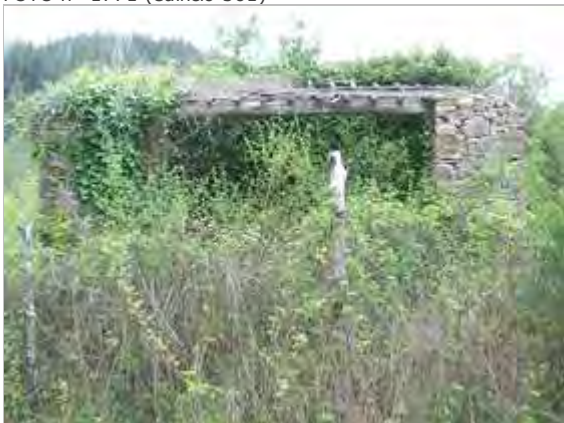
Categoria: Degrado fisico
