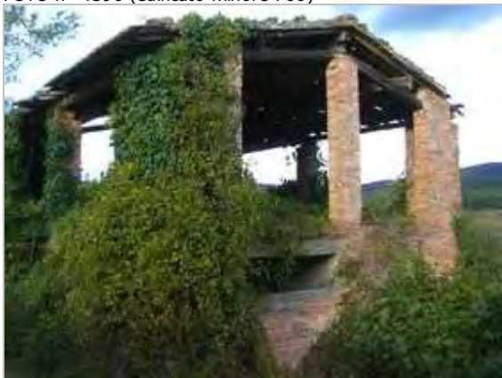
Categoria: Degrado fisico
