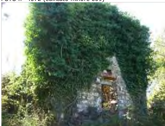
Categoria: Degrado fisico
