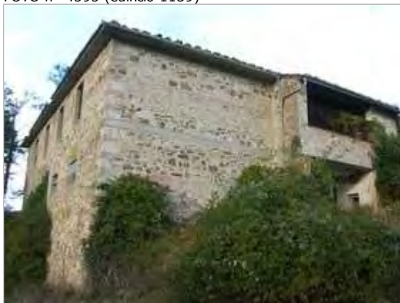
Categoria: Degrado fisico
