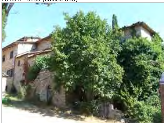
Categoria: Degrado fisico
