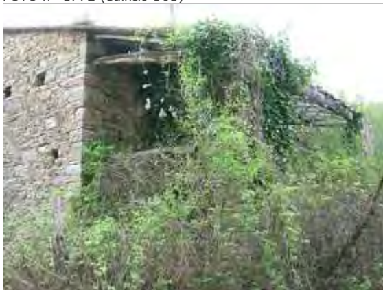
Categoria: Degrado fisico
