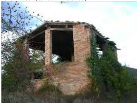
Categoria: Degrado fisico
