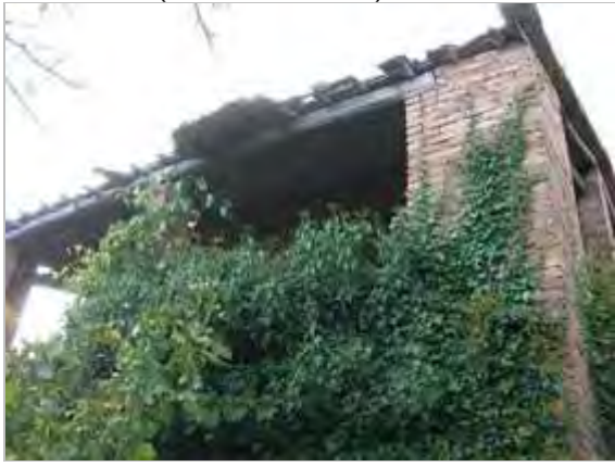
Categoria: Degrado fisico
