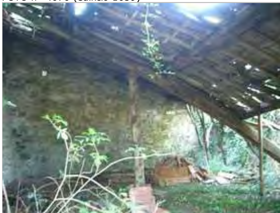
Categoria: Degrado fisico
