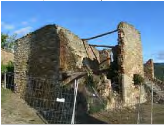
Categoria: Degrado fisico
