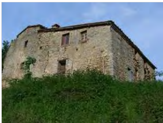
Categoria: Degrado fisico
