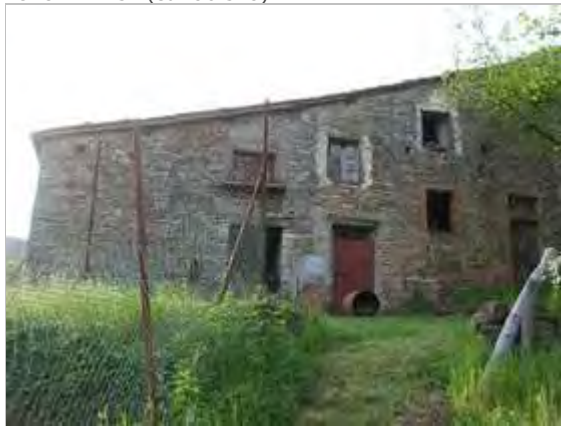
Categoria: Degrado fisico
