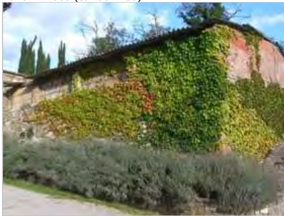
Categoria: Degrado fisico
