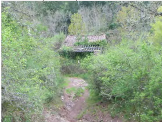
Categoria: Degrado fisico
