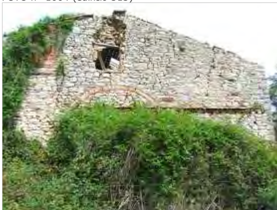
Categoria: Degrado fisico
