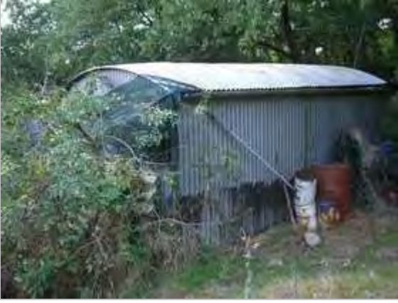
Categoria: Degrado fisico
