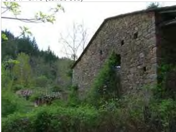
Categoria: Degrado fisico
