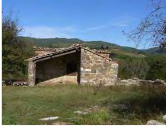
Categoria: Degrado fisico
