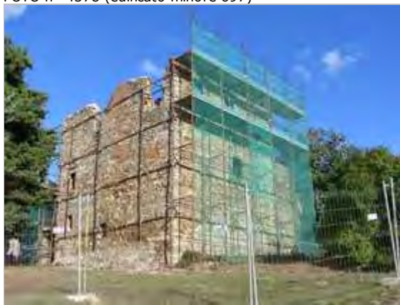
Categoria: Degrado fisico
