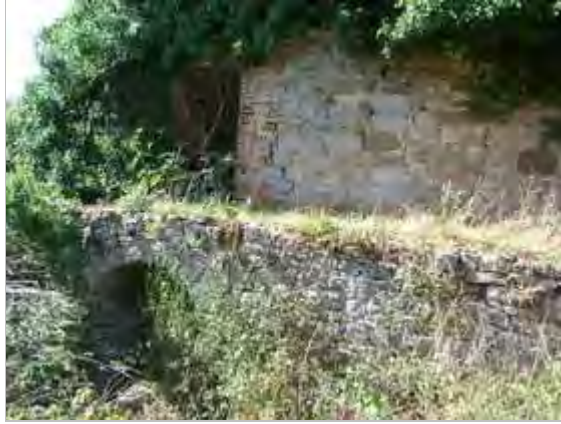
Categoria: Degrado fisico
