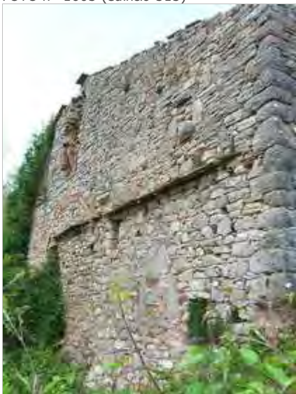
Categoria: Degrado fisico
