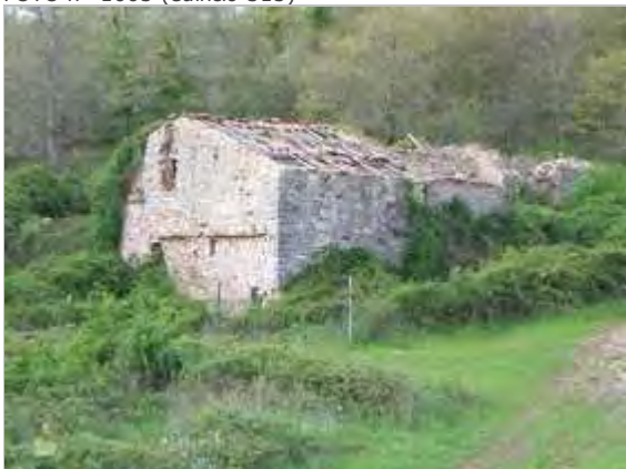
Categoria: Degrado fisico
