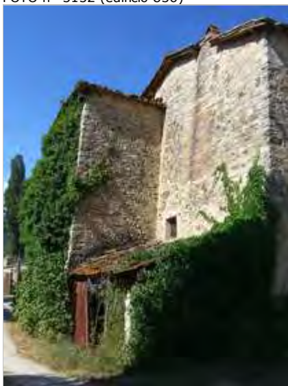
Categoria: Degrado fisico
