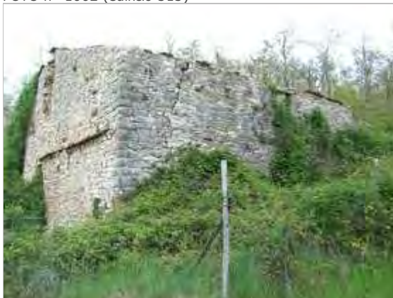
Categoria: Degrado fisico
