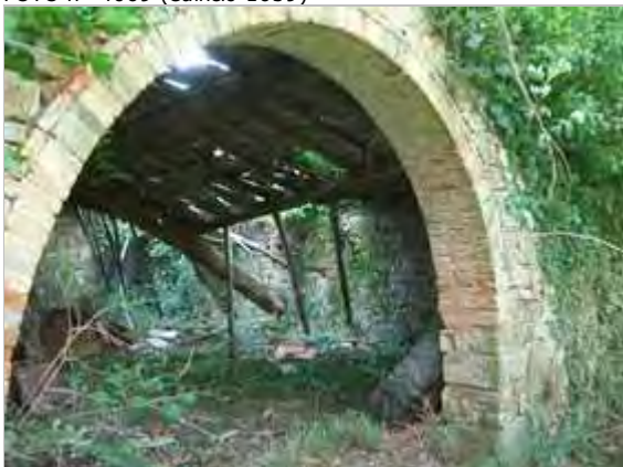
Categoria: Degrado fisico
