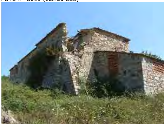
Categoria: Degrado fisico
