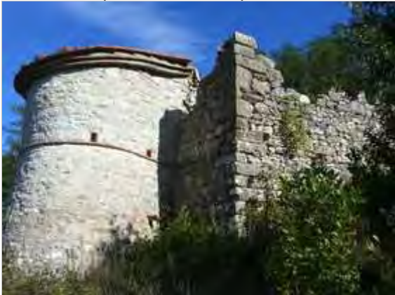
Categoria: Degrado fisico
