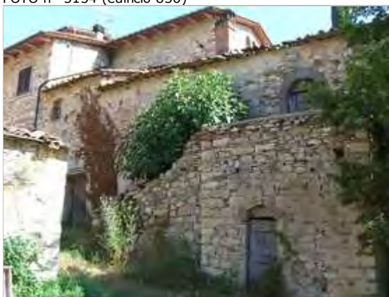
Categoria: Degrado fisico
